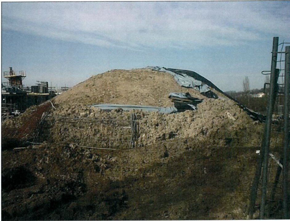
Figure 25 : Stockage des terres polluées au 1 er mars 2013
